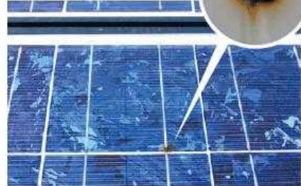
配線の接続不良などにより太陽電池パネルの一部が焦げると、屋根にまで被害が及び恐れがある
